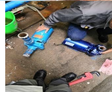
válvula de 2" de alimentación de agua
