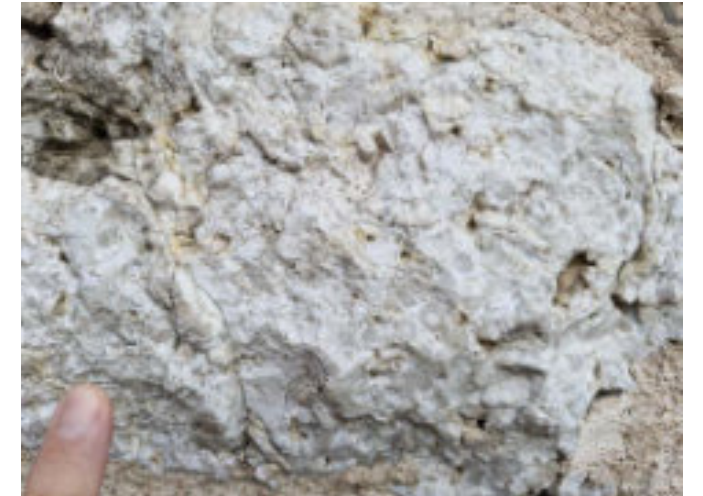
Detalle de un fragmento de roca carbonática, incrustada en un cajón de mampostería del monasterio de las Descalzas Reales. Obsérvese gran cantidad de fósiles. Foto del autor.
