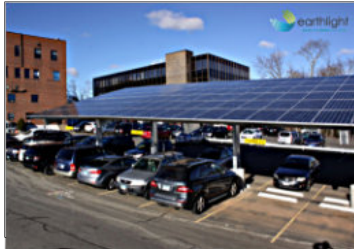
Figura 7. Estación de recarga de EVs con energía solar (Sepisolar, 2024).
