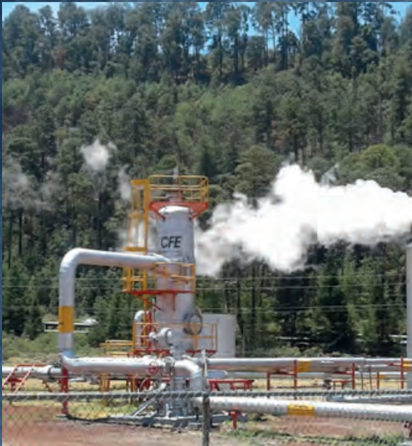
Figura 13. Pozo geotermal activo en el campo geotermoelectrico de Los Azufres en Michoacan (Mengelle, 2025a).
